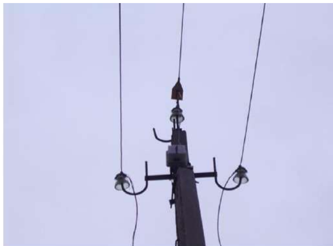
Рис. 3. Электронный блок передающего устройства ФИНКЗ и подвешенный к фазному проводу высоковольтный резистор
