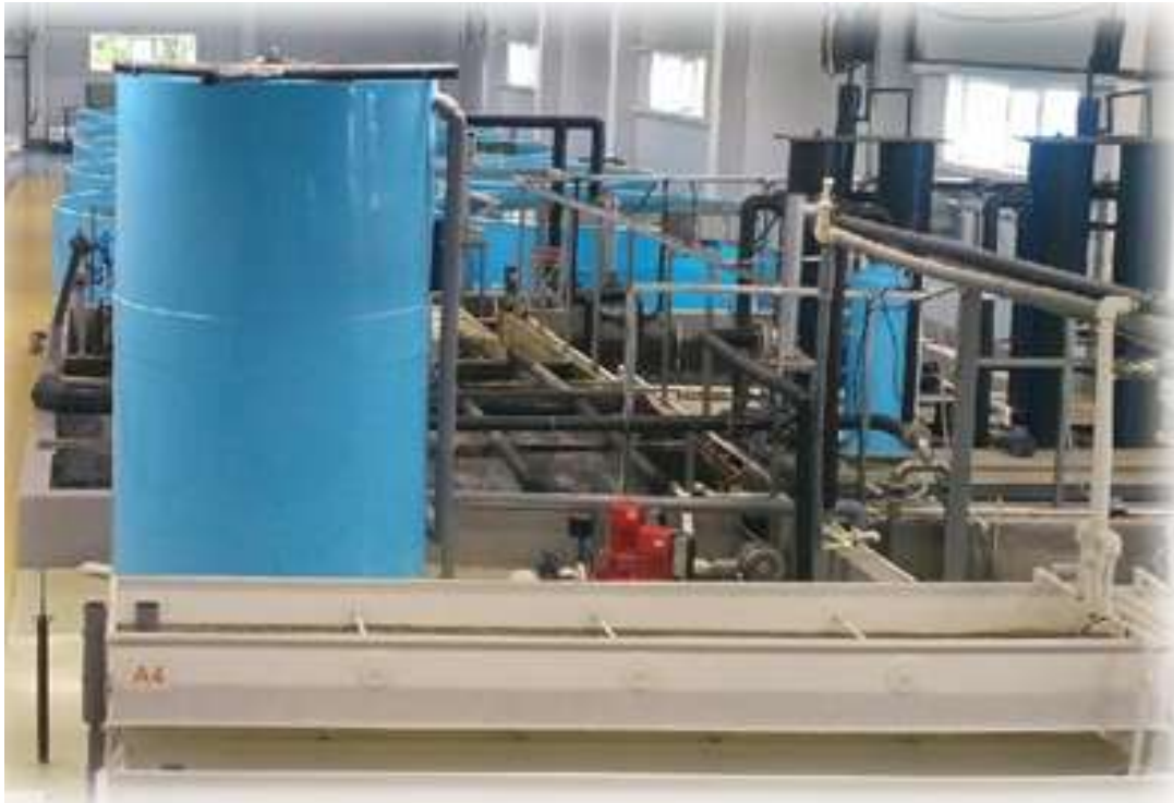
Рисунок 2- Установка замкнутого цикла водоснабжения по выращиванию осетровых рыб на ООО «Биосфера-Фиш»
