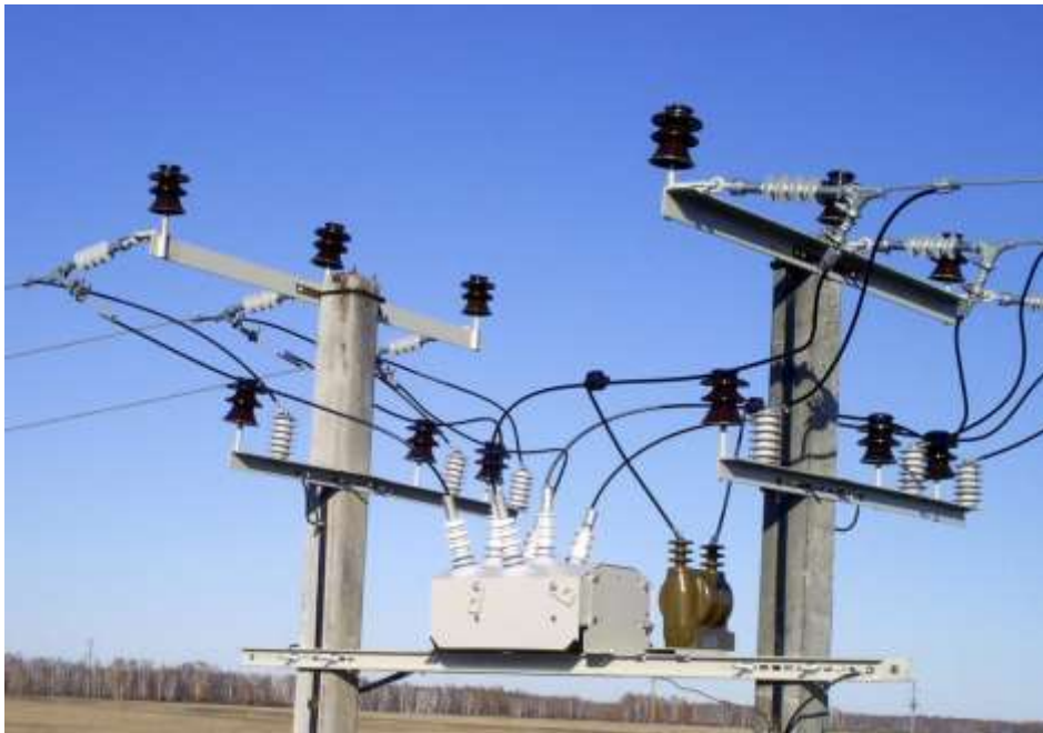
Рис. 2 – Внешний вид реклоузера, установленного на высоковольтной опоре
