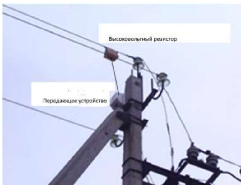
Рис.5 - Фиксирующий индикатор направления короткого замыкания (ФИНКЗ), установленный на высоковольтной опоре
